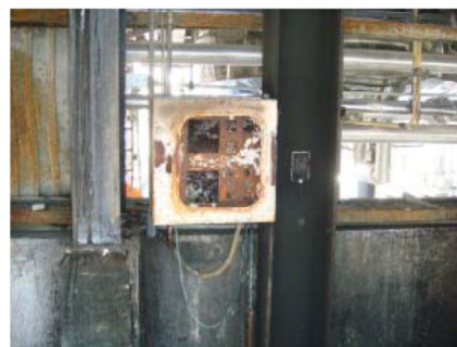
圖2 事故現場所使用之控制配電箱
