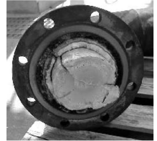
圖1 堵塞的排氣管
